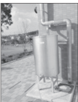
雨水貯水槽:雨水を貯め、植物の水やりに使う
